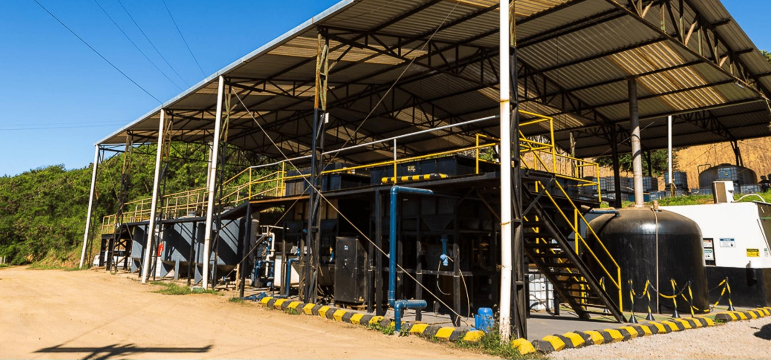
Estação de Tratamento de Efluentes - Chorume
